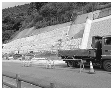
第26図 「道の駅オアシスなんもく」前の道路側面の擁壁工事
